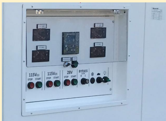
Quadro di controllo
